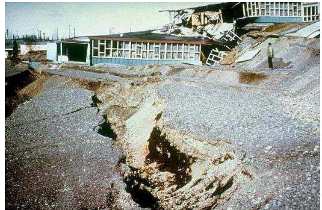
Escola Elementar de Government Hill destruída por subsidência que ocorreu durante o terremoto de 1964. Note a grande rachadura produzida pelo terremoto (magnitude 9,2).
