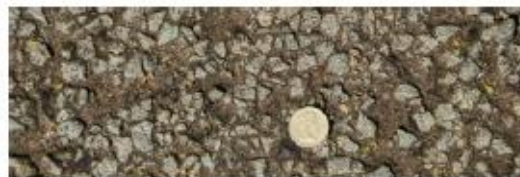
Superfície de uma estrada desgastada com o agregado elevado acima da matrix de betume. Moeda para escala
