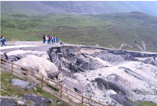
Mam Tor – a velha estrada, agora seriamente danificada pelo deslizamento de terra, e intransitável desde 1977. (Fotografias: Peter Kennett)
