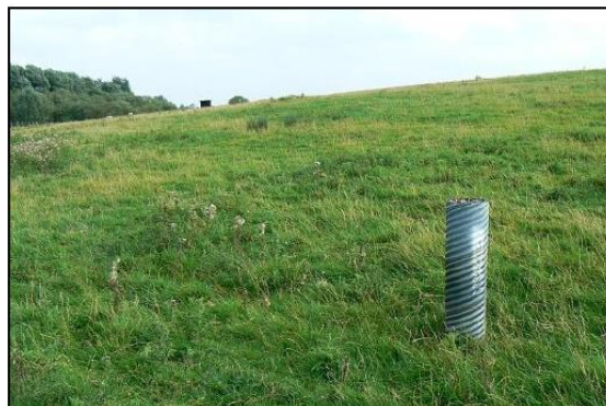
Respiradouro para liberar metano potencialmente perigoso de um preenchimento de depósito de lixo de uma antiga pedreira, Severn Way, próximo a Hempsted, Gloucestershire, Reino Unido.
