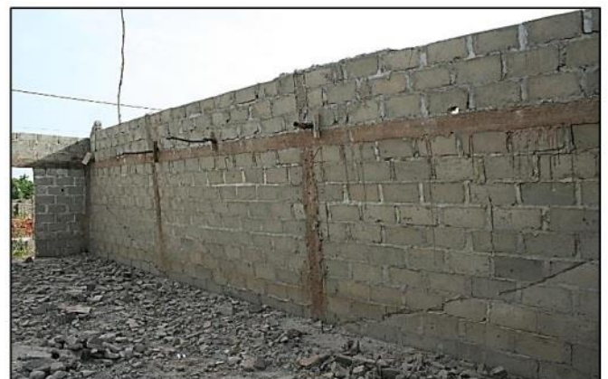
Uma parede danificada pelo clima de monções na Gâmbia.
