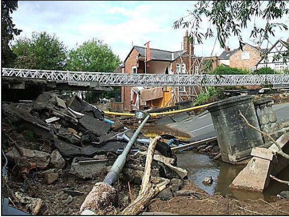
Burway Bridge sobre o Rio Corve, Ludlow, Inglaterra depois de inundações.
